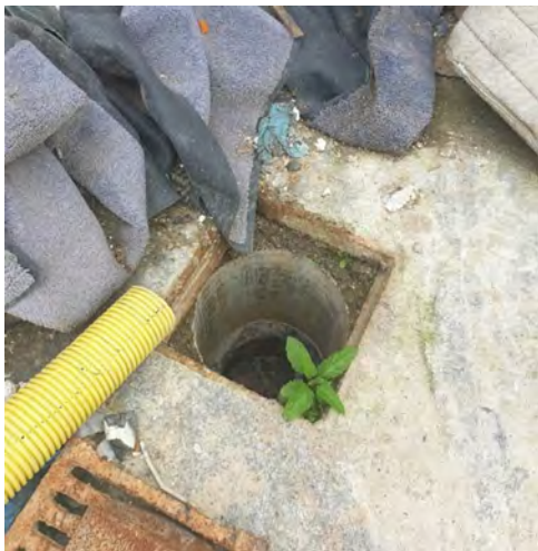
Figur 16 Ett antal dagvattenbrunnar som är kopplade till en stenkista ska finnas under Stora avfallshögen. Dagvattenbrunnarna ska ha haft filter som skulle bytas med vissa tidsintervall. I nuläget kan endast brunnen på bilden ses, resterande ska ligga under Stora avfallshögen. Inga filter finns i aktuell brunn.
